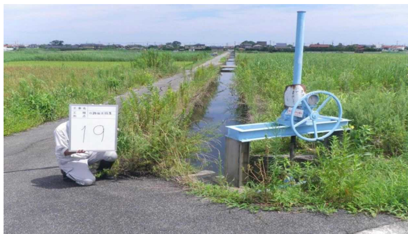
④No.29 管渠出口の土砂堆積状況
