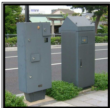
信号制御機と発電機
