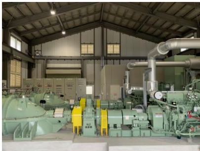
整備済みの排水機場
