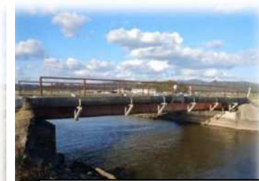
老朽化した水管橋
