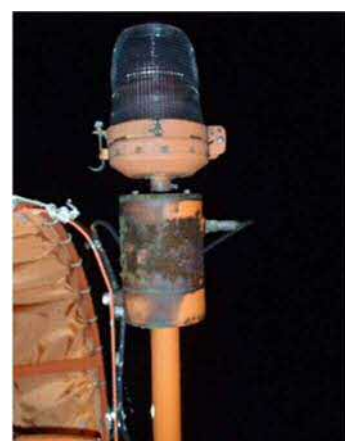
写真一 航空灯火劣化状況
