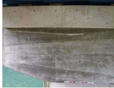
〔橋脚〕 近接目視で容易に視認できるひび割れがあり、顕著な漏水が継続しているなどにより、急速に劣化が進展すると見込まれる
