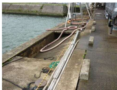
写真－１２ 上部工の陥没
