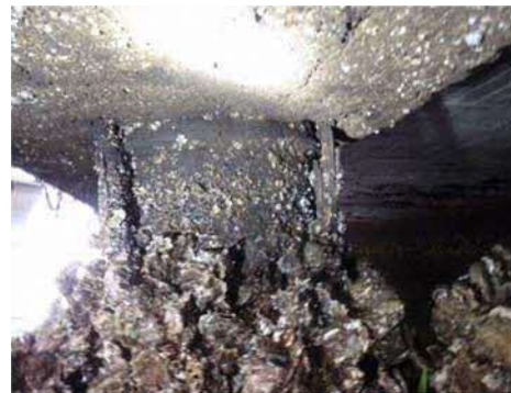
写真－１４ 杭頭部の腐食
