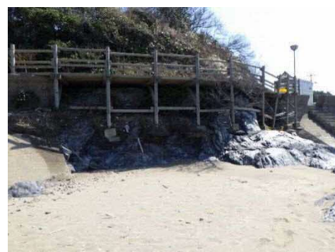
写真－9 侵食による基礎部の露呈
