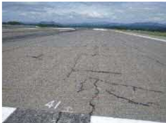
写真-5 滑走路ひび割れ発生状況
