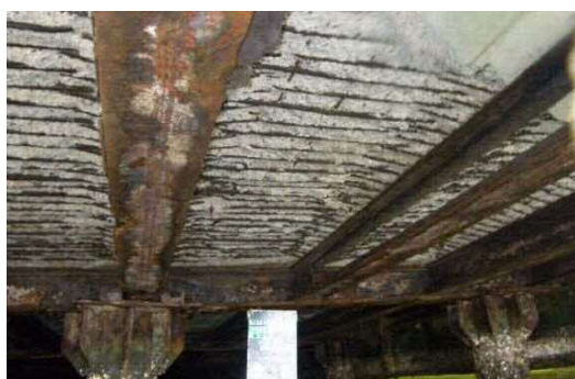
写真－１３ 上部工の劣化（下面側）
