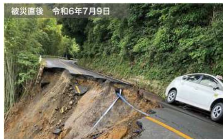
被災状況写真
