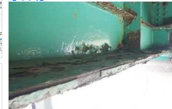
鋼部材の腐食等
