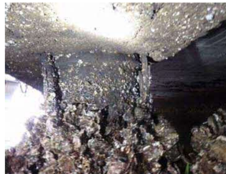
写真－１４ 杭頭部の腐食
