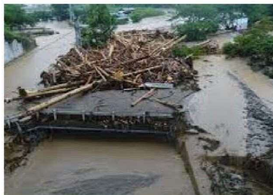
平成 29 年 7 月 九州北部豪雨 大量の流木が橋梁に詰まり氾濫
