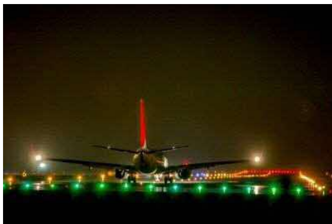
写真一 航空灯火点灯状況(出雲空港)
