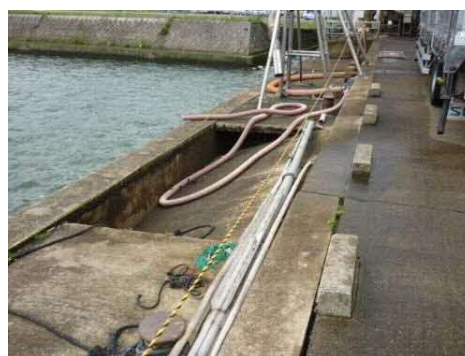
写真－１２ 上部工の陥没
