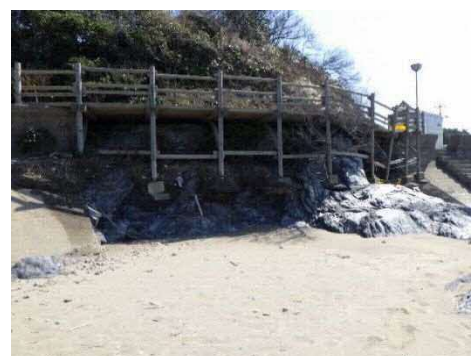
写真－9 侵食による基礎部の露呈
