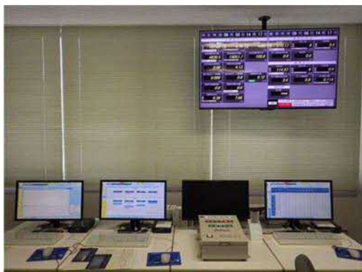
(更新が完了したダム管理用制御処理装置)
