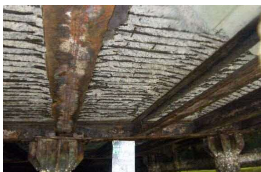
写真－１３ 上部工の劣化（下面側）
