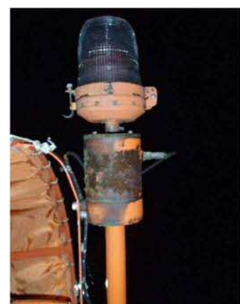
写真二 航空灯火劣化状況
