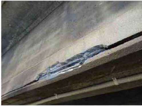
〔主桁〕 近接目視で容易に視認できるひび割れがあり、内部の鉄筋やPC鋼材の腐食が進行
