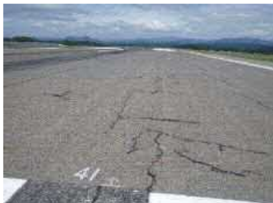
写真-5 滑走路ひび割れ発生状況
