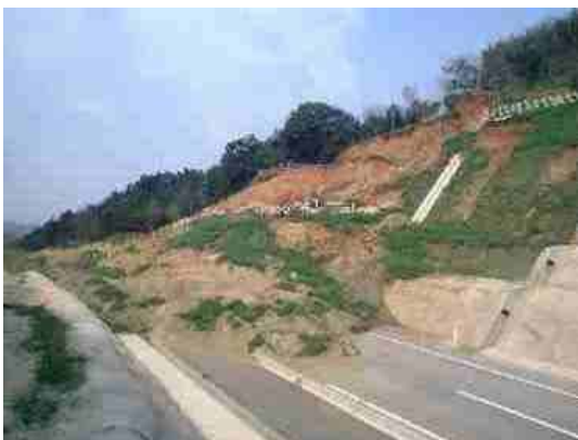
主要地方道松江鹿島美保関線 (梅雨前線豪雨；松江市)
