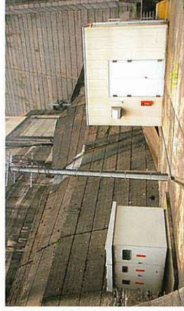
八戸川第三発電所
