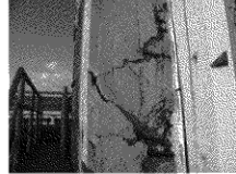
水門の門柱部のコンクリ剥離
