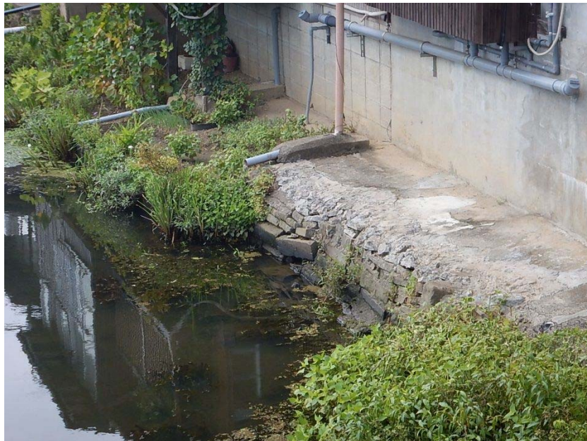
写真-3.2.4 河岸の崩落状況（近景）
