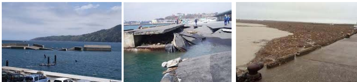
図 3-9 港湾の被災状況
