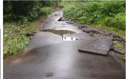
写真：舗装の被災
