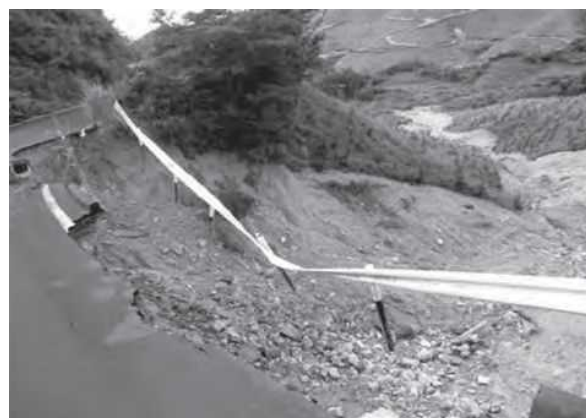
林道施設被害（邑南町） （林道施設災害復旧事業で擁壁工施工）
