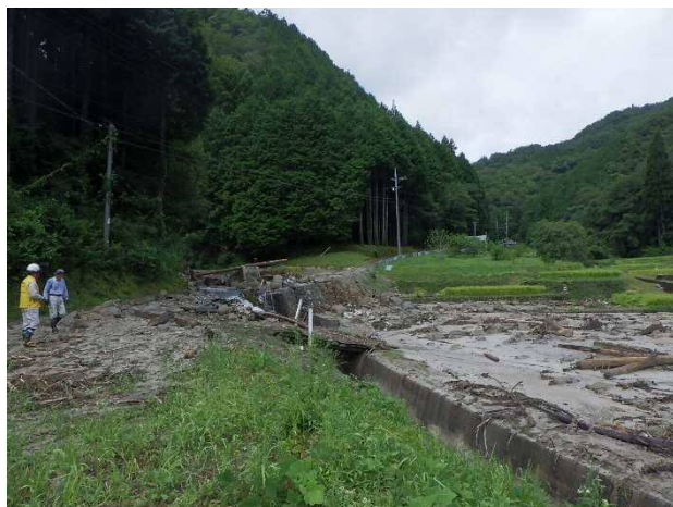
土石流によって被災した市道と水田
