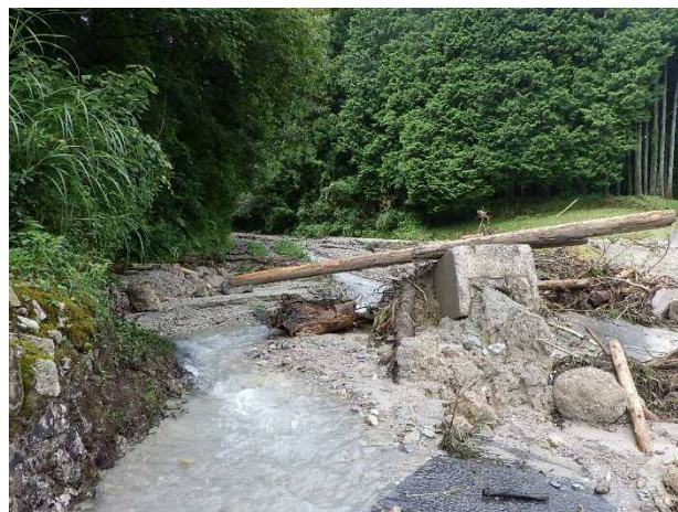
市道の被災状況(左の写真の中央部)
