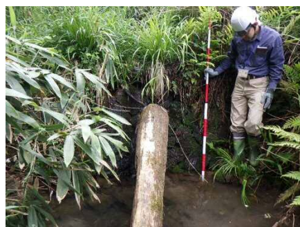
昭和23年施工の古い石積み (写真中央は流木の丸太)
