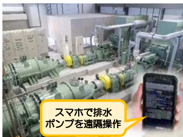
〈用排水機場のICT化〉
