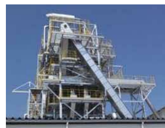
<木質バイオマス発電所>
