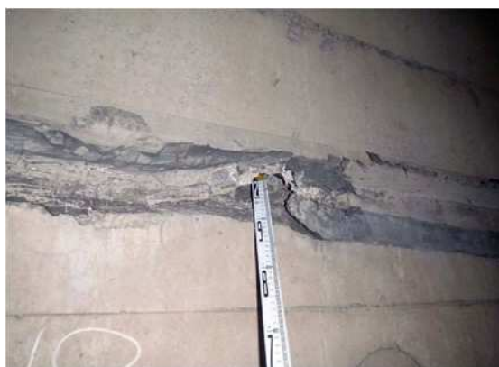
壁面打継部の剥離
