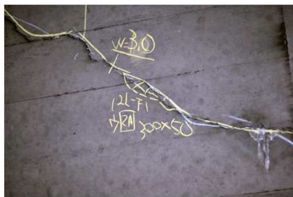
覆工アーチ部のひび割れ
