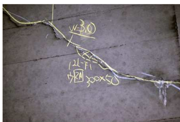
覆工アーチ部のひび割れ
