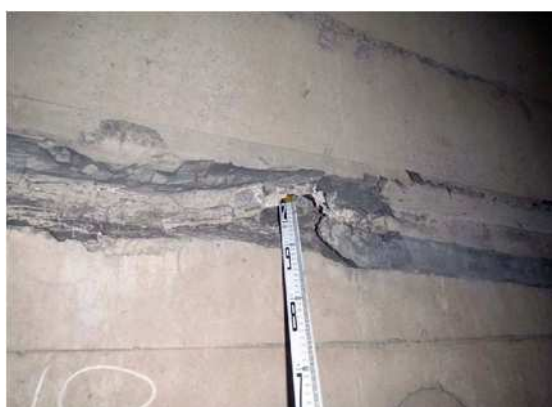
壁面打継部の剥離
