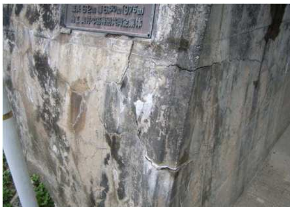
抗門面壁のひび割れ
