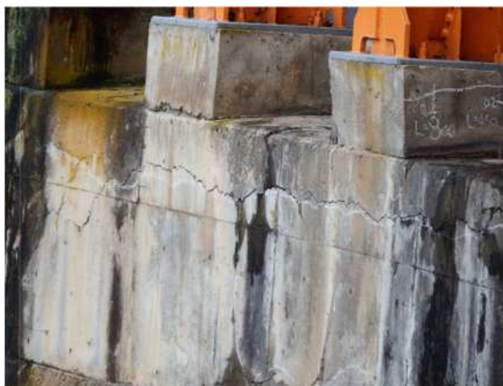
受台のひび割れ
