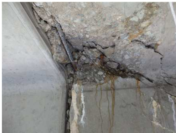
はく落を伴う鉄筋露出（頂版）
