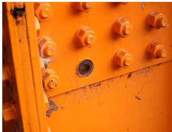
取付ボルト（F11T）の破断
