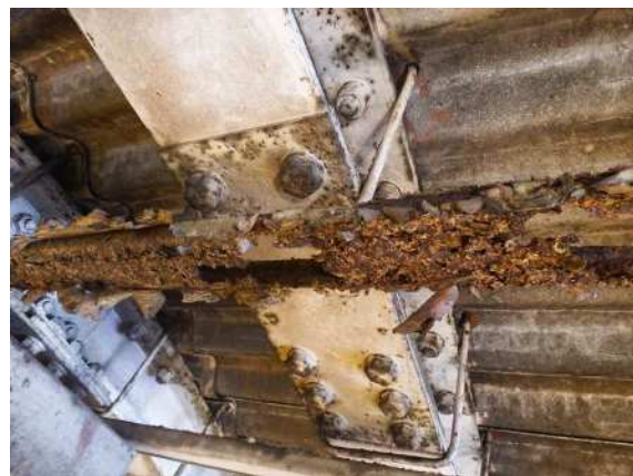
照明取付レールの断面欠損、破断
