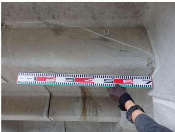
ひび割れ、はく離・はく落（横梁）
