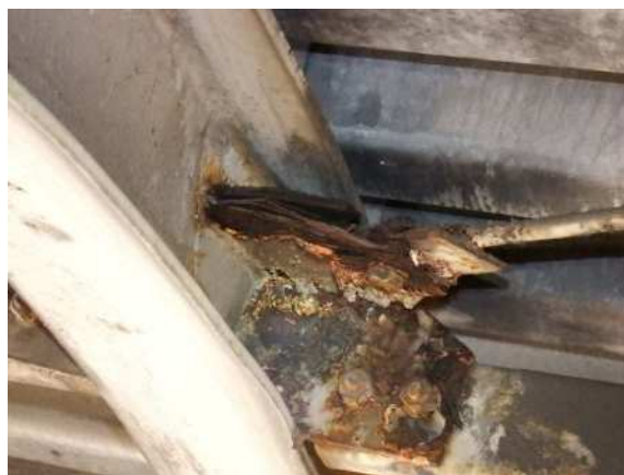
ガセットプレート部分の腐食
