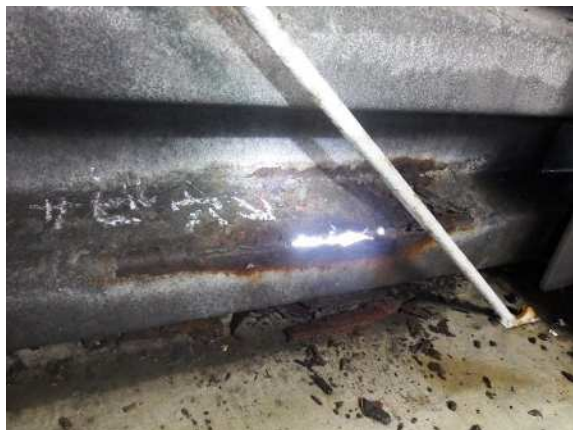
頂版の断面欠損
