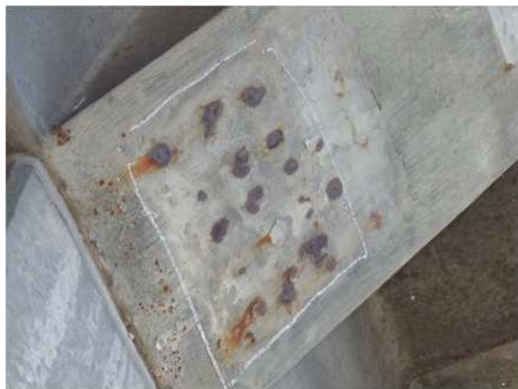
PC 鋼材からの錆汁（主梁）
