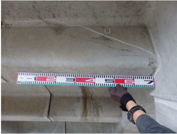
ひび割れ、はく離・はく落（横梁）
