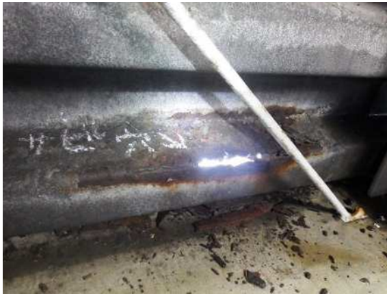
頂版の断面欠損
