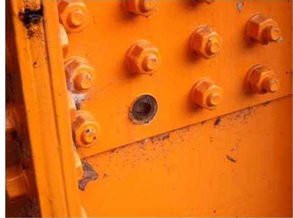
取付ボルト (F11T) の破断
