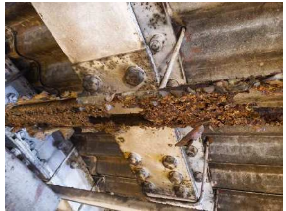
照明取付レールの断面欠損、破断
