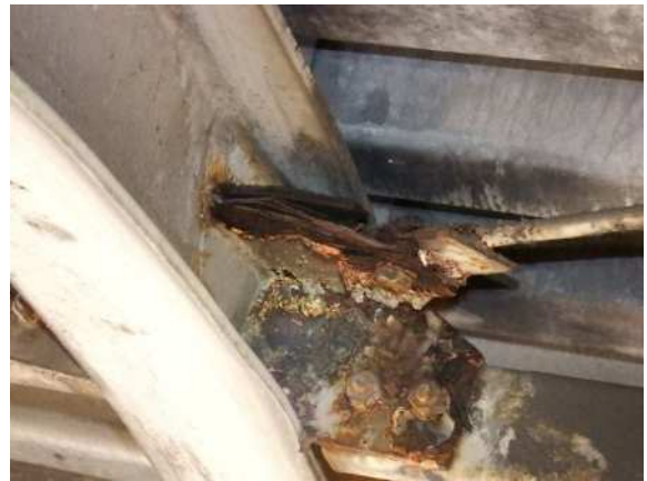
ガセットプレート部分の腐食
