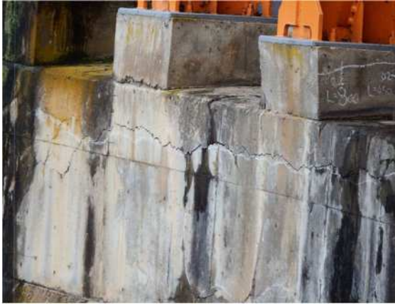
受台のひび割れ
