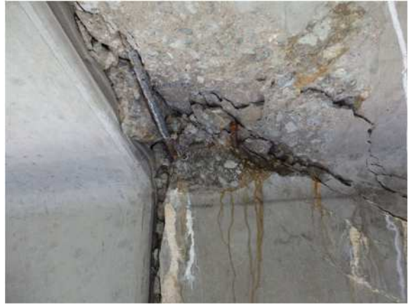
はく落を伴う鉄筋露出（頂版）
