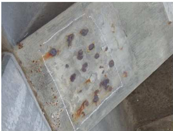
PC 鋼材からの錆汁（主梁）
