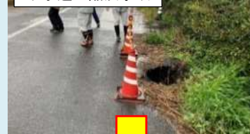
下水道 陥没事故
