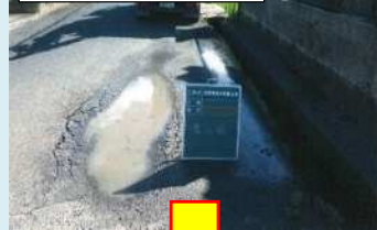
上水道 漏水事故
