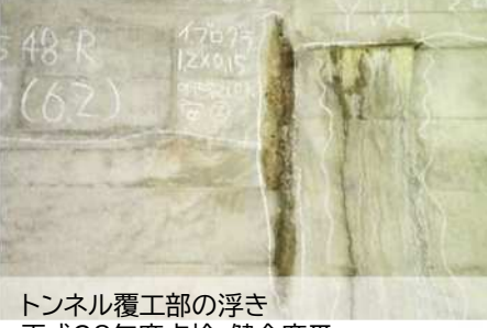
トンネルの損傷事例
