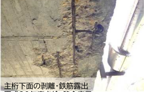
道路橋の損傷事例
