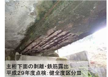
道路橋の損傷事例
