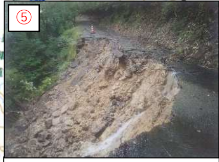
⑤ (一) 大社立久恵線 出雲市芦渡町～乙立町 (路肩崩落)
