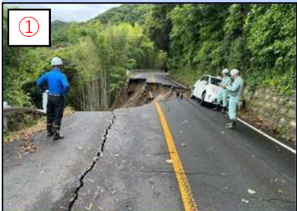
① (主)大社日御碕線 出雲市大社町日御碕 (道路崩落)
