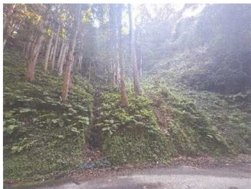
山からの出水による土砂流出の恐れ
