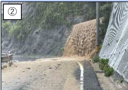
② (主) 斐川一畑大社線 出雲市塩津町 (路面冠水)
