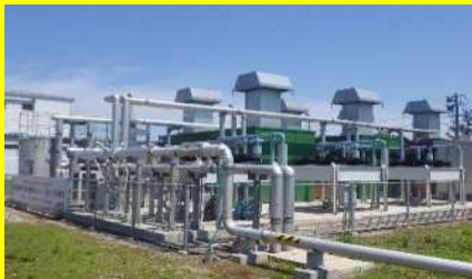
発電施設 【東部浄化センター】
