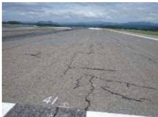
写真一5 滑走路ひび割れ発生状況
