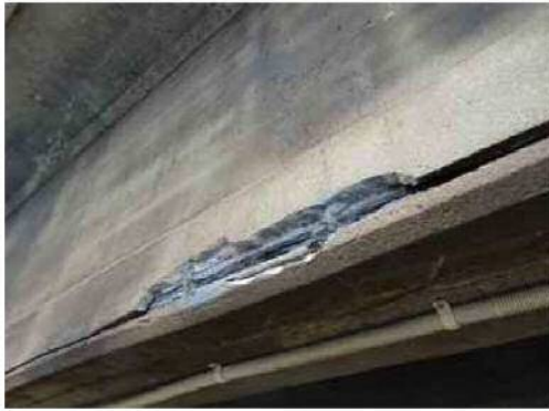
〔主桁〕 近接目視で容易に視認できるひび割れがあり、内部の鉄筋やPC鋼材の腐食が進行
