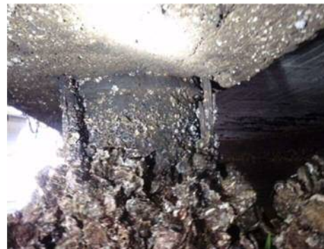
写真－１４ 杭頭部の腐食
