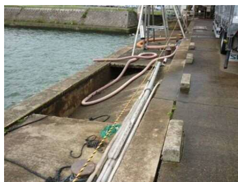
写真－１２ 上部工の陥没
