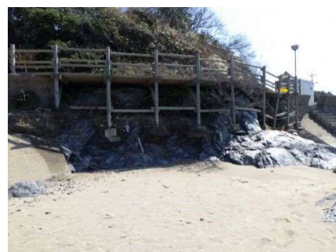
写真－9 侵食による基礎部の露呈
