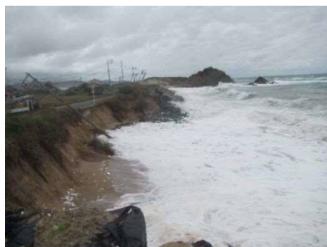
(侵食による被害状況)
