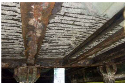
写真－１３ 上部工の劣化（下面側）
