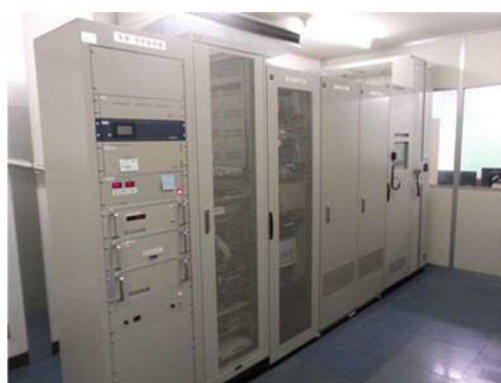
(更新が完了したダム管理用制御処理装置)
