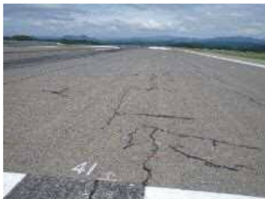
写真一5 滑走路ひび割れ発生状況
