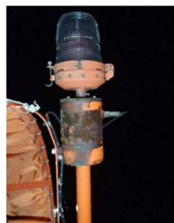
写真一 航空灯火劣化状況
