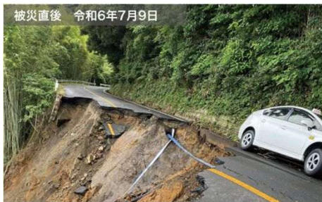
被災状況写真
