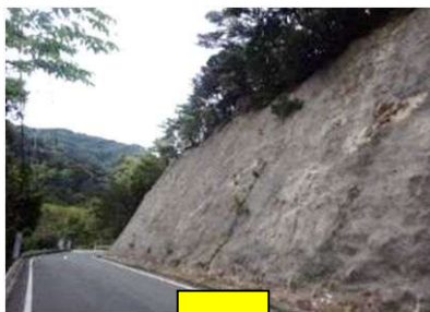
道路の落石対策
