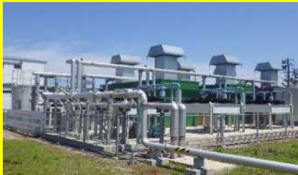
発電施設 【東部浄化センター】
