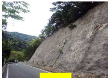
道路の落石対策
