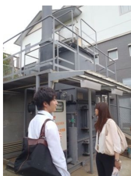
(a) チップボイラー
