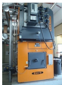
(b) チップボイラー
