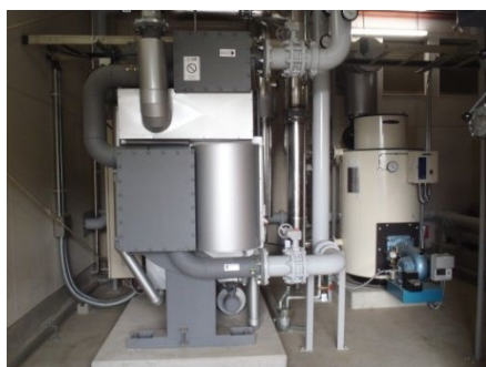
(c) 吸収冷凍機
