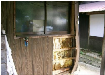
民家壁のハチ巣への被害
